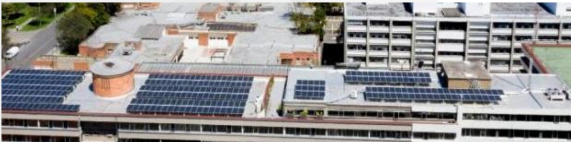
Ilustración 53 Foto - Paneles solares sede principal
